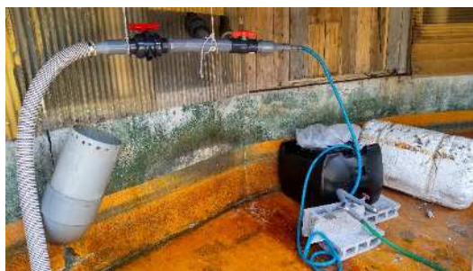
図 3 陸上養殖場への設置状況
