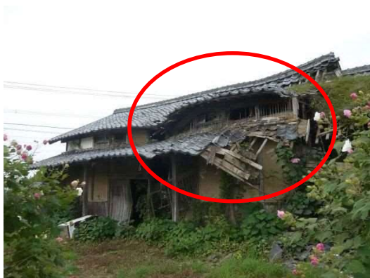
屋根が一部脱落している
