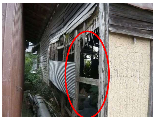
外壁材が無くなっている
