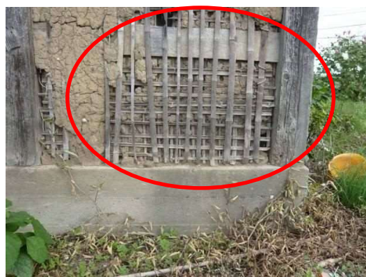
外壁材が剥がれて土壁が露出
