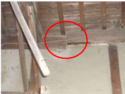
梁の接合部がずれている
