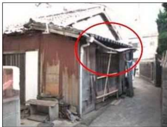
雨樋が破損し飛散する危険がある
