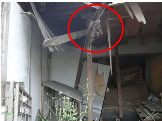
柱、梁が破損している
