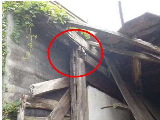
梁の腐食により欠損している
