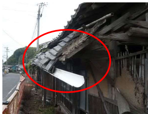
屋根、軒が垂れ下がっている
