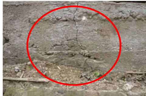
基礎にひび割れが発生している
