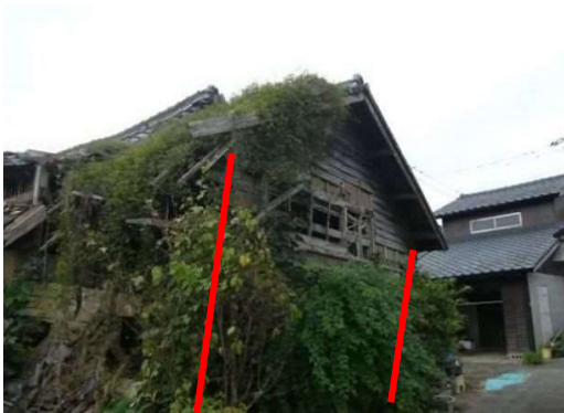
建物が傾斜し、道路に倒壊の危険
