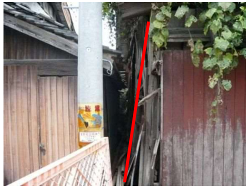
柱が傾斜している
