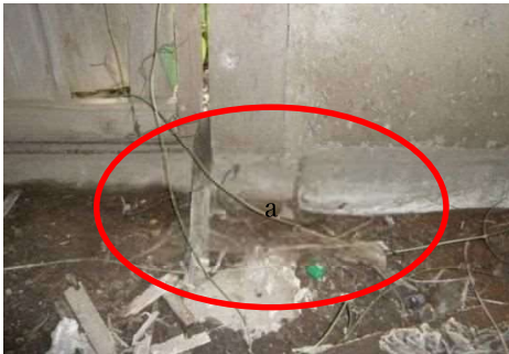
基礎、土台がずれている
