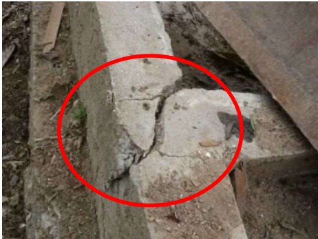
基礎がひび割れ、土台が無い
