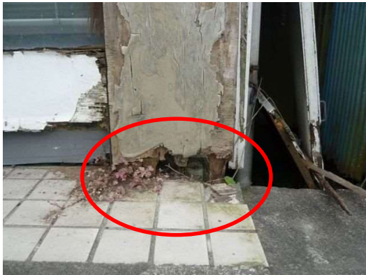
柱脚が腐朽し欠損している
