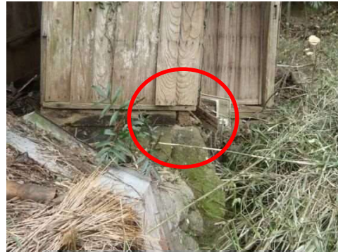
土台が腐朽して欠損している
