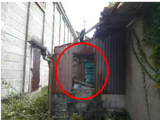
門扉がなく侵入できる
