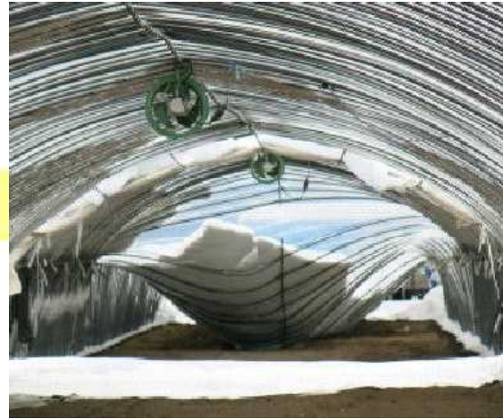
写真1 天井部が倒壊したハウス
