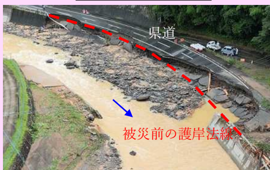
【県道の被災状況】
