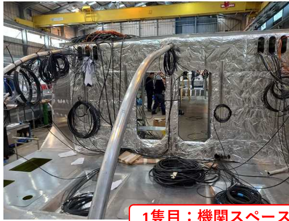
1隻目：機関スペース
