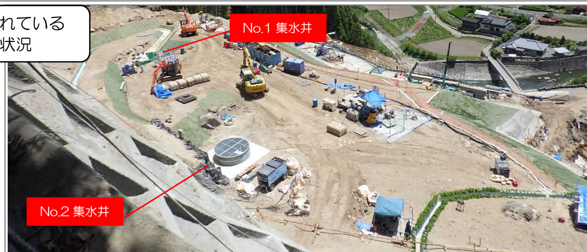
集水井によって集められた地下水
