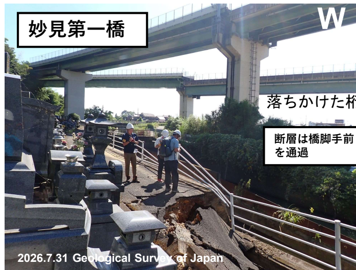
断層を境にした地盤のくい違いで被災した橋梁
