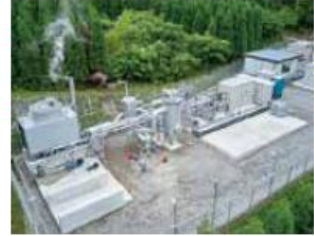
地熱発電電力を活用した 水素製造実証事業
