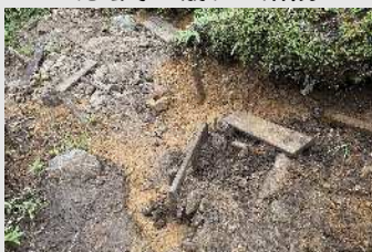
洗堀等で崩れた階段
