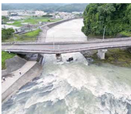
三郎丸橋被災状況 令和6年7月時点
