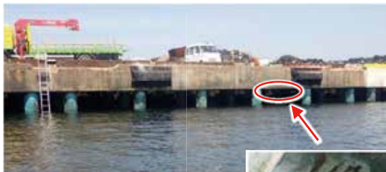
港湾岸壁の劣化状況 (大分港 住吉地区)
