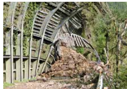
平成28年熊本地震による被災状況 国道212号(日田市)
