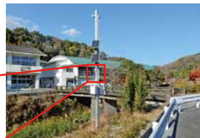
簡易型河川監視カメラ
