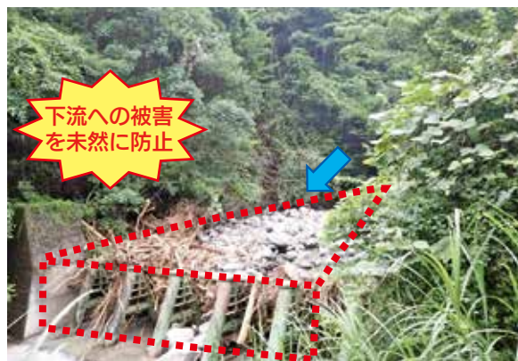
2023年に土砂・流木を捕捉した 荻木川(中津市)の流木捕捉工
