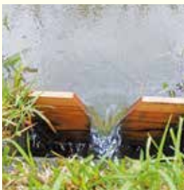
田んぼダム堰板設置の事例
