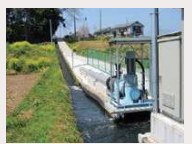
竹田市 城原井路小水力発電所
