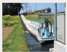
竹田市 城原井路小水力発電所
