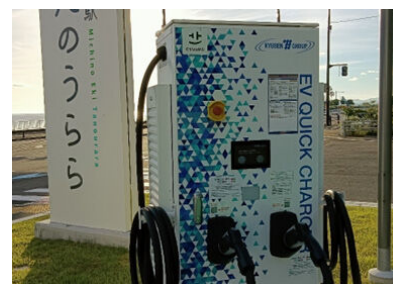
道の駅におけるEV充電機器 (道の駅たのうらら:大分市)
