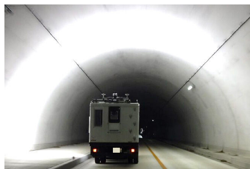
レーザーと高解像カメラを搭載した専用車両による走行型のトンネル点検
