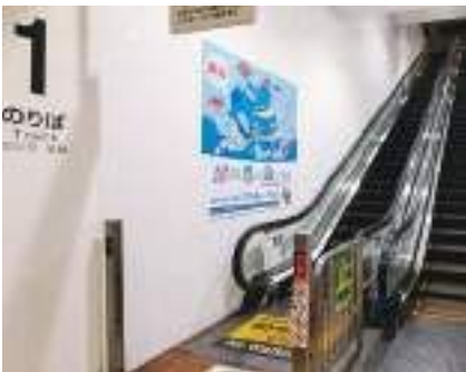
大分駅 エスカレーター(全4か所)
