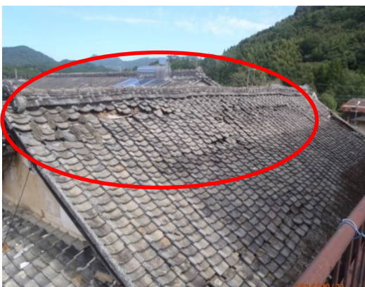
屋根ふき材が落下するおそれがある
