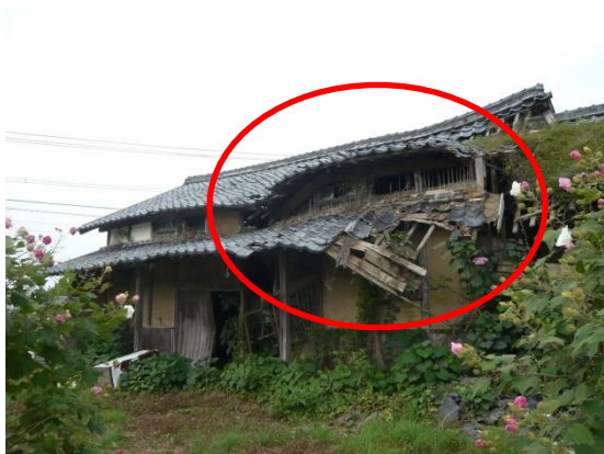
屋根が一部脱落している
