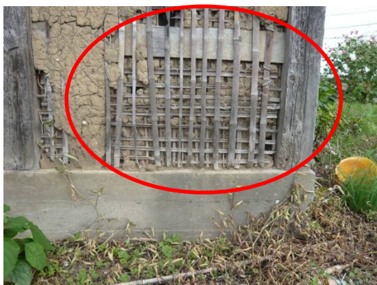
外壁材が剥がれて土壁が露出
