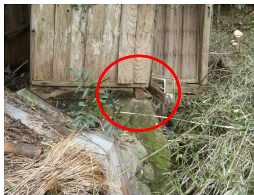
土台が腐朽して欠損している
