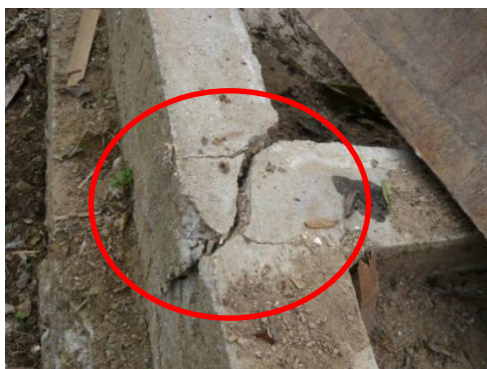
基礎がひび割れ、土台が無い
