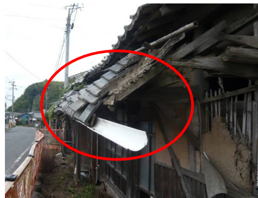
屋根、軒が垂れ下がっている
