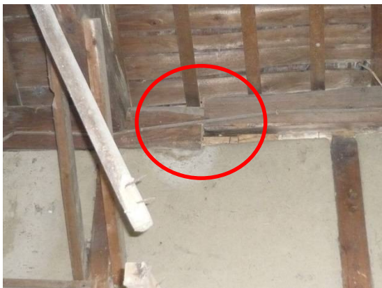
梁の接合部がずれている
