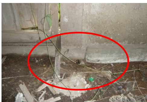
基礎、土台がずれている
