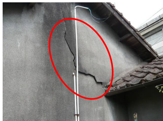
外装材が剥落し落下するおそれがある
