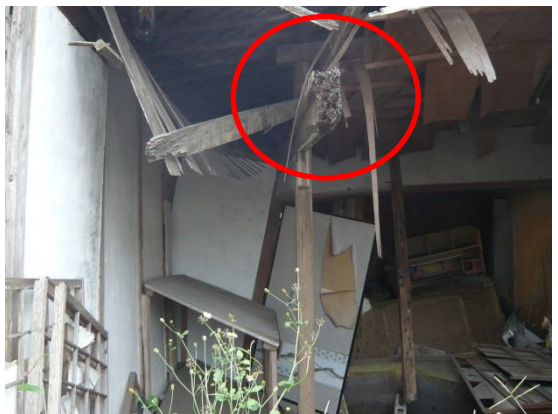
柱、梁が破損している
