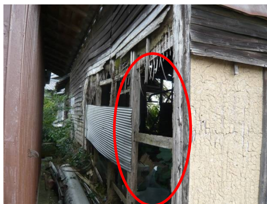
外壁材が無くなっている
