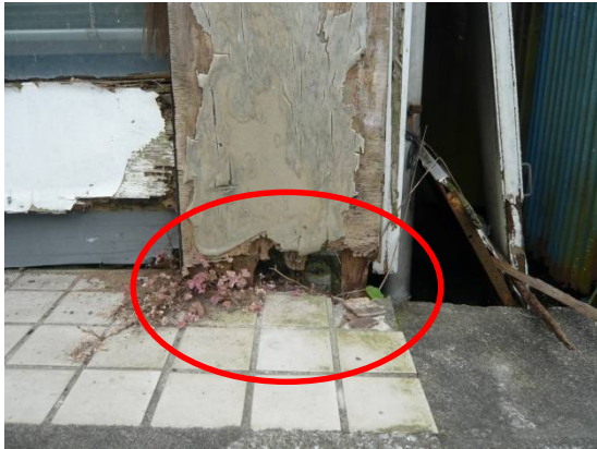
柱脚が腐朽し欠損している
