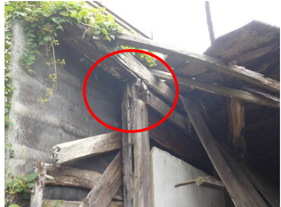
梁の腐食により欠損している
