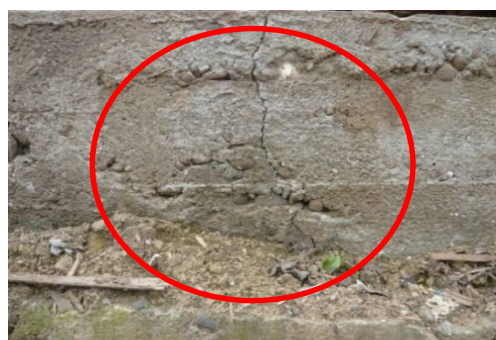
基礎にひび割れが発生している
