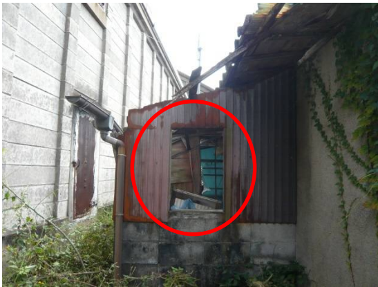
門扉がなく侵入できる
