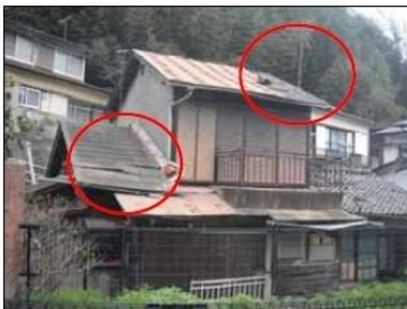
屋根ふき材が周囲に飛散する危険がある
