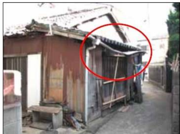
雨樋が破損し飛散する危険がある
