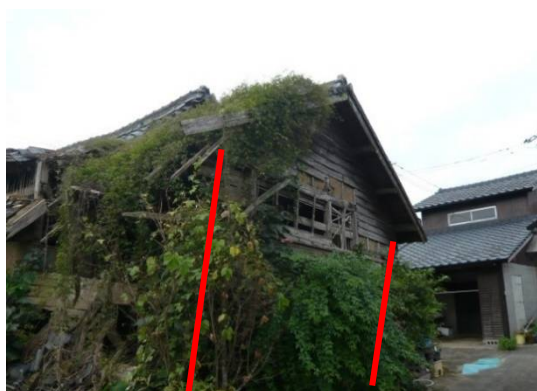
建物が傾斜し、道路に倒壊の危険
