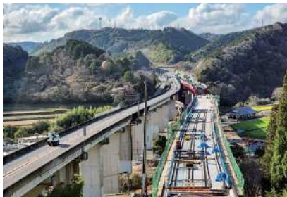
4車線化が進む東九州自動車道（宇佐IC～院内IC） （香下大橋）
