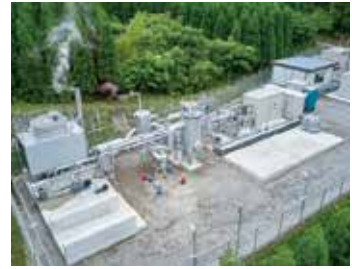
地熱発電電力を活用した 水素製造実証事業
