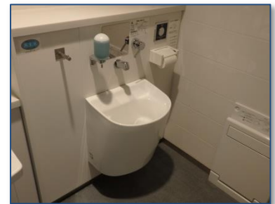
▲オストメイト対応設備
