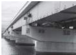
落橋を防ぐ耐震対策 (主要地方道大分大分港線大分大橋：大分市)
