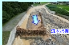
小野川 (日田市) の流木捕捉 (R5梅雨前線豪雨)
