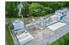
地熱発電電力を活用した水素製造実証事業
