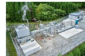
地熱発電電力を活用した水素製造実証事業
