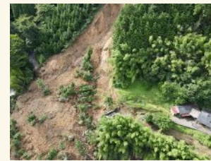
ドローンによる被災箇所調査
