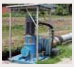
竹田市 城原井路小水力発電所
