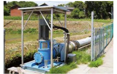
農業用水を活用した小水力発電(城原井路発電所)
