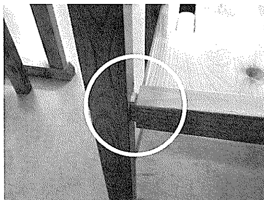
写真-3 ほぞの破損
